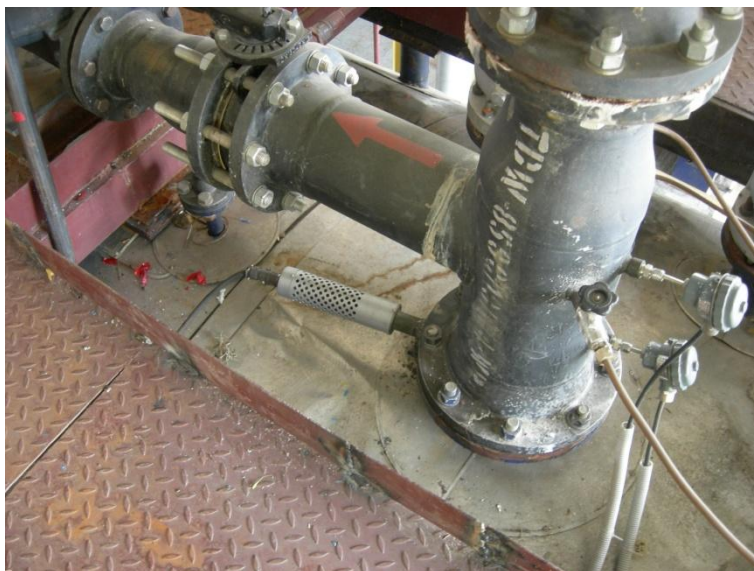
Излучатель ультразвука на фланце выходного патрубка жаротрубного водогрейного котла.
